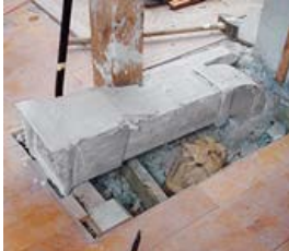
Lüftungskanal aus Asbestzement
