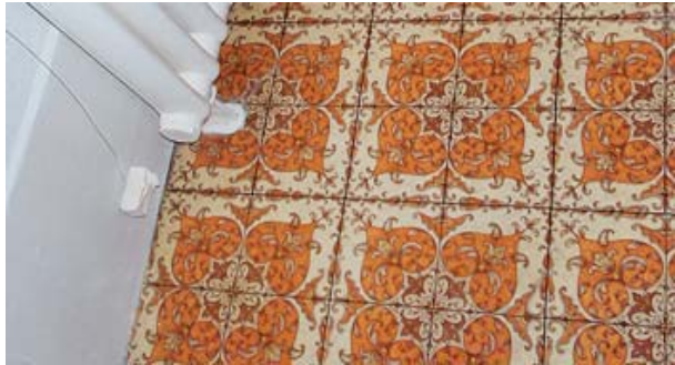
Typisches Muster eines mehrschichtigen asbesthaltigen Bodenbelags
