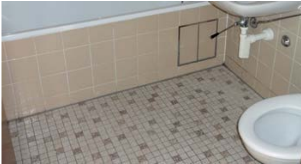
Plättli an Boden und Wänden mit asbesthaltigem Kleber
