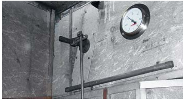
Lüftungskanal aus Asbestzementplatten
