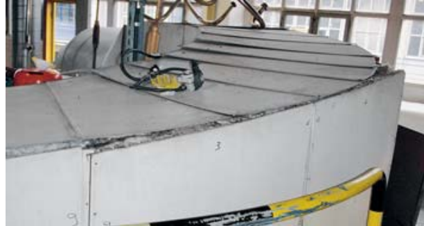
Asbesthaltige Dämmung hinter einer Verkleidung
