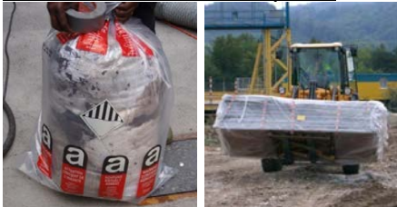
Festgebundener Asbest in Säcken oder mit Kunststofffolie staubdicht
