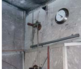
Lüftungsanlage aus Asbestzement
