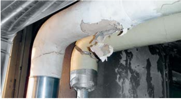
Rohrleitung mit asbesthaltigem Mörtel
