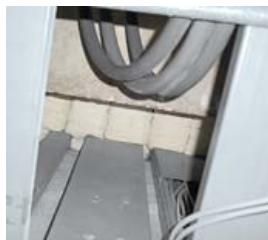
Brandabschottung mit Asbestkissen
